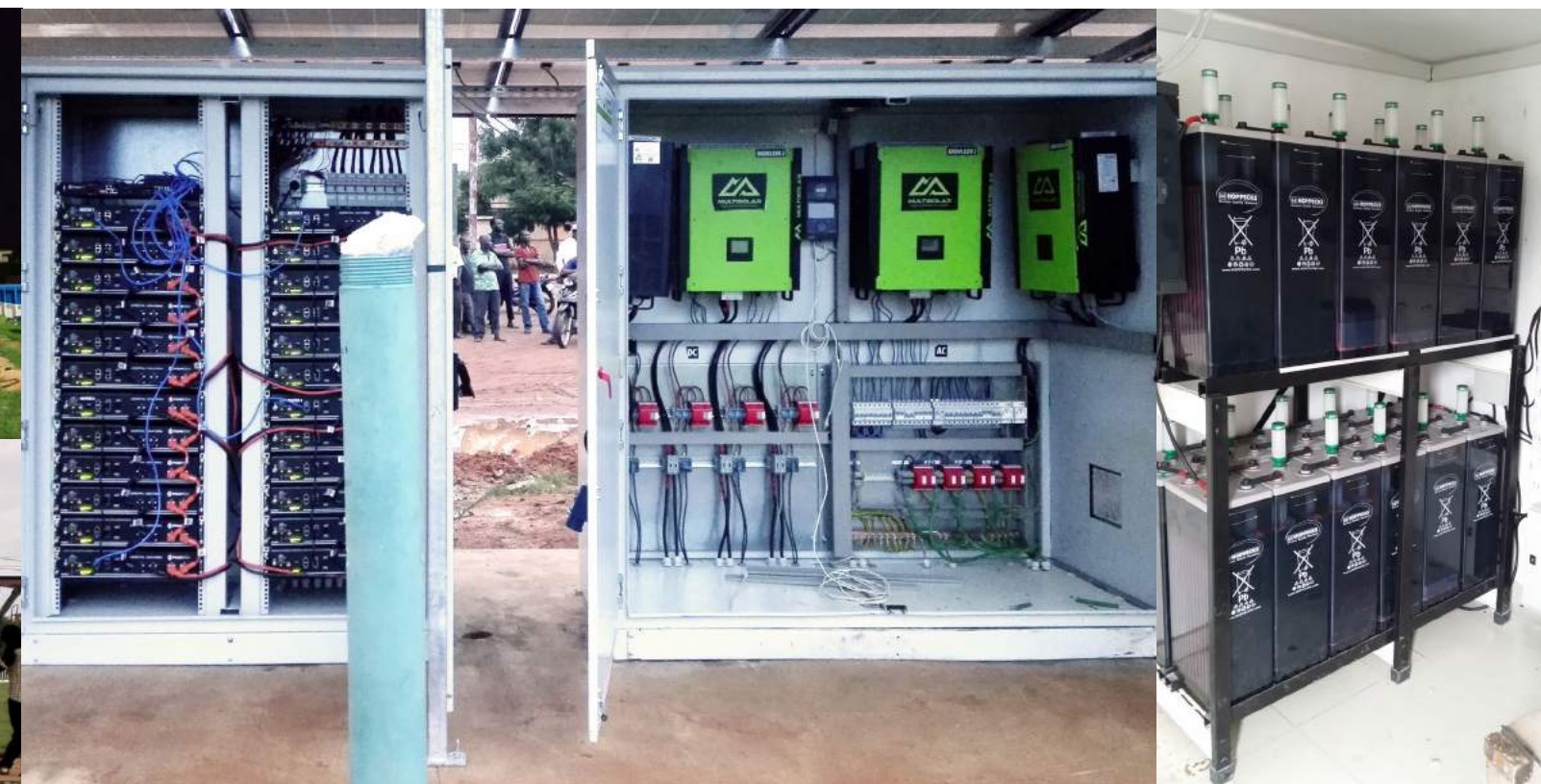
Installation de parcs de batteries
